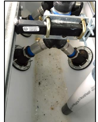
Fig. 8 - under dispenser containment (UDC)
